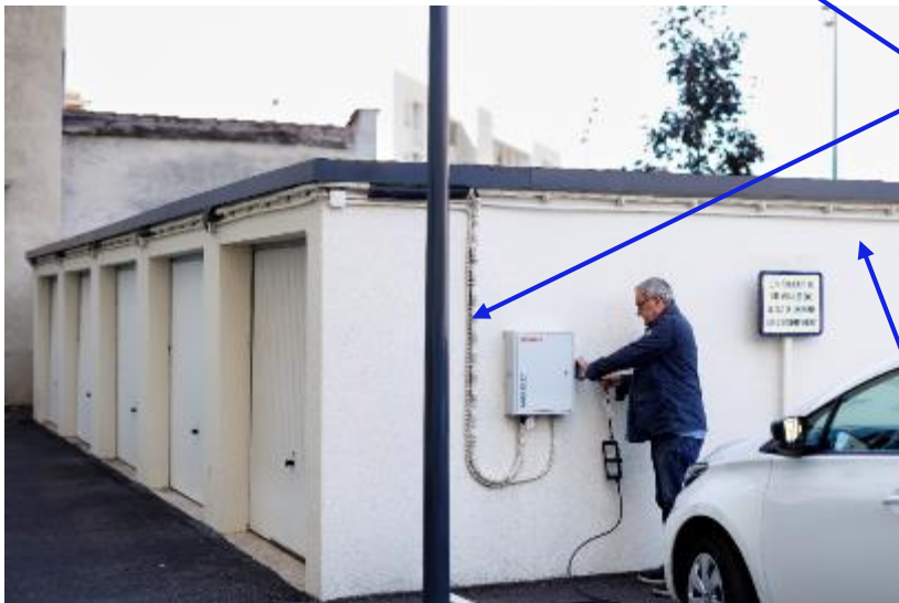
Dérivation individuelle sur façade
